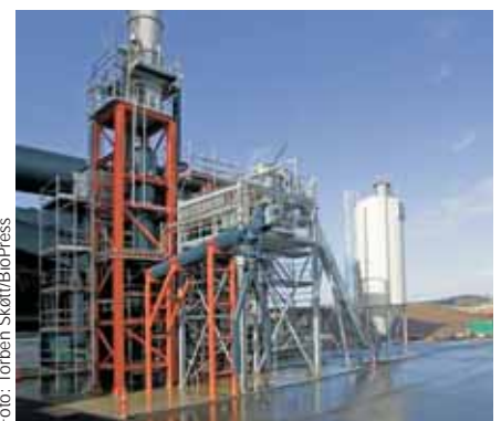
Foto: Torben Skott/BioPress Anlæg til halmforgasning i Kalundborg.
