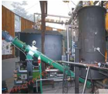
Forsøgsanlæg i Ansager i Sønderjylland, hvor en modstrømsforgasser leverer energi til en Stirling-motor. Anlægget har en el-effekt på 40 kW.
