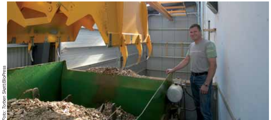
Driftsleder Torben Brand Andersen ved kranen, der forsyner såvel forgasser som kedel med skovflis.
