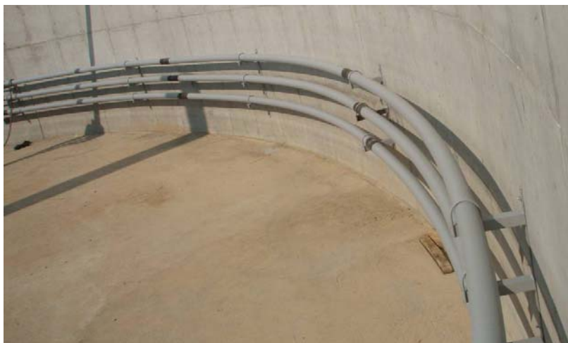
Figura 7.17. Conducte pentru încălzit amplasate în interiorul digesterului (AGRINZ GmbH, 2008)
