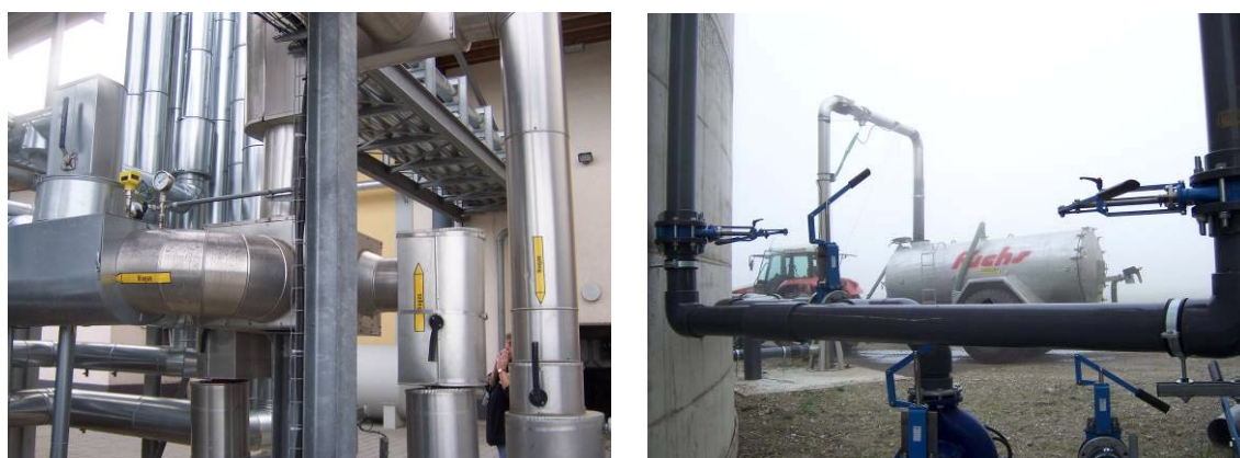
Figura 7.15. Conducte de gaz izolate (stânga) și conducte pentru digestat (dreapta) (RUTZ, 2008)
