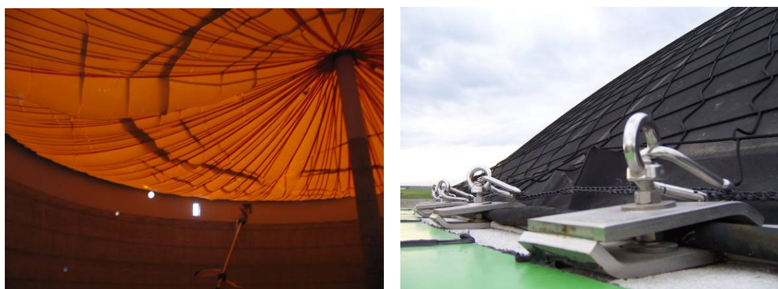
Figura 7.26. Copertină constituită dintr-o membrană impermeabilă pentru gaze, montată peste digestor, văzută din interiorul acestuia (stânga) (AGRINZ GmbH, 2006), și vedere din exterior; se observă plasa specială de limitare a extinderii (dreapta) (RUTZ, 2006)
