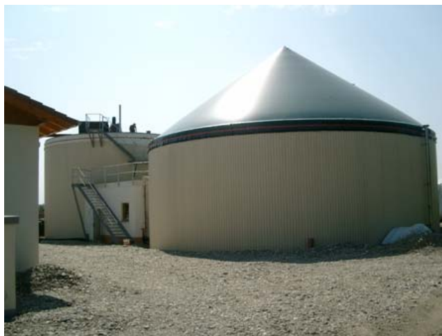
Figura 4.7. Digester vertical din Germania, construit în 2005 pentru digestia biomasei provenite din culturi energetice (KRIEG & FISHER, 2008)
