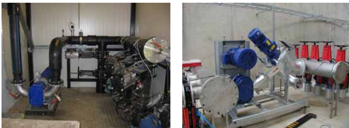
Slika 7.9. Sustavi za pumpanje
