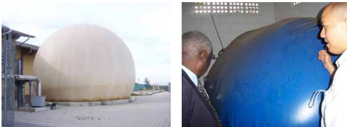
Slika 7.26. Vanjsko niskotlačno spremište za skladištenje plina
