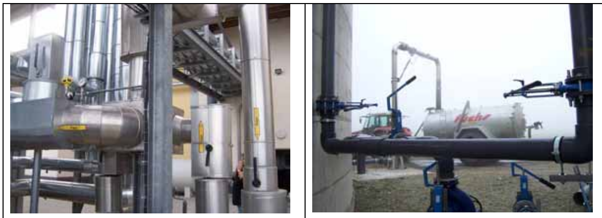
Slika 7.15. Izolirane cijevi za plin (lijevo) i cjevovod za digestat (desno)
