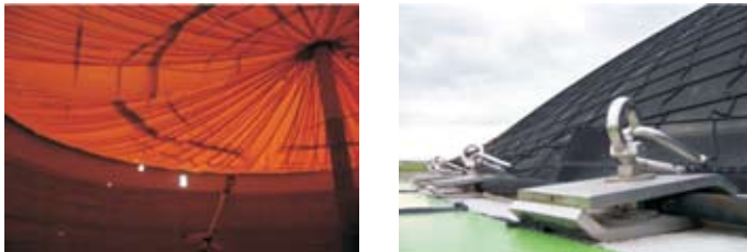
Slika 7.27. Plinotesna membrana; pogled znotraj digestorja -levo. Vir: AGRINZ 2006; Plinotesna membrana opremljena z mrežo, ki omejuje raztezanje -desno. Vir: RUTZ, 2006
