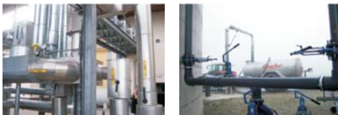
Slika 7.15. Izoliran plinovod -levo; Cevovod za presnovljeni substrat -desno. Vir: RUTZ 2008
