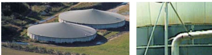
Slika 7.33. Skladiščni rezervoarji pokriti z membrano. Vir: Danish Biogas Association, 2008
