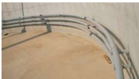
Slika 7.17. Ogrevalne cevi v digestorju. Vir: AGRINZ 2008
